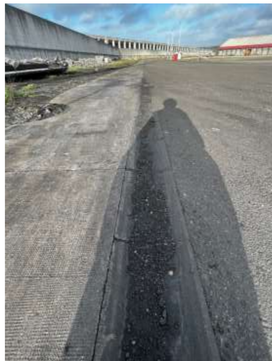
Foto 18. Rigola en el vial principal en la zona del dique
