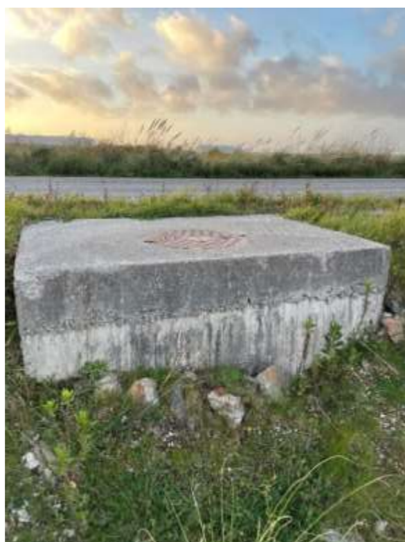
Foto 22. Arqueta de MT
