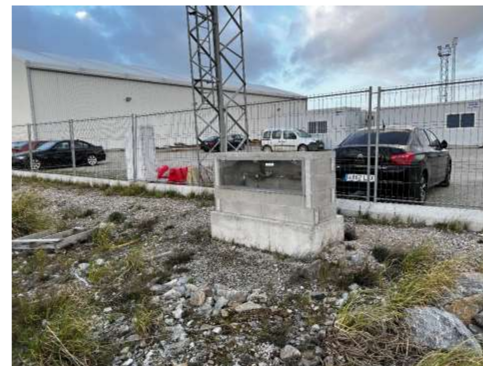
Foto 24. Acometida de abastecimiento
