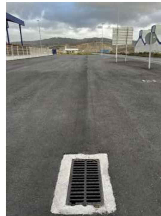
Foto 16. Drenaje en la explanada de oleosilos
