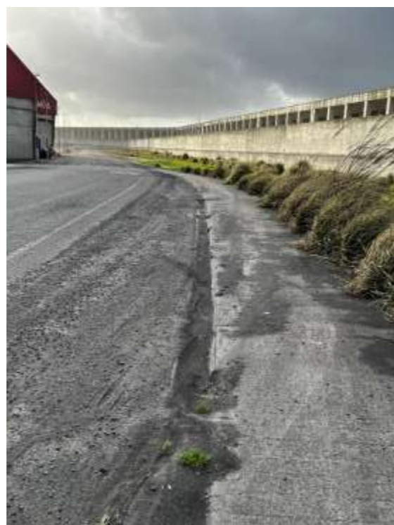
Foto 19. Rigola en el vial principal en la zona del dique
