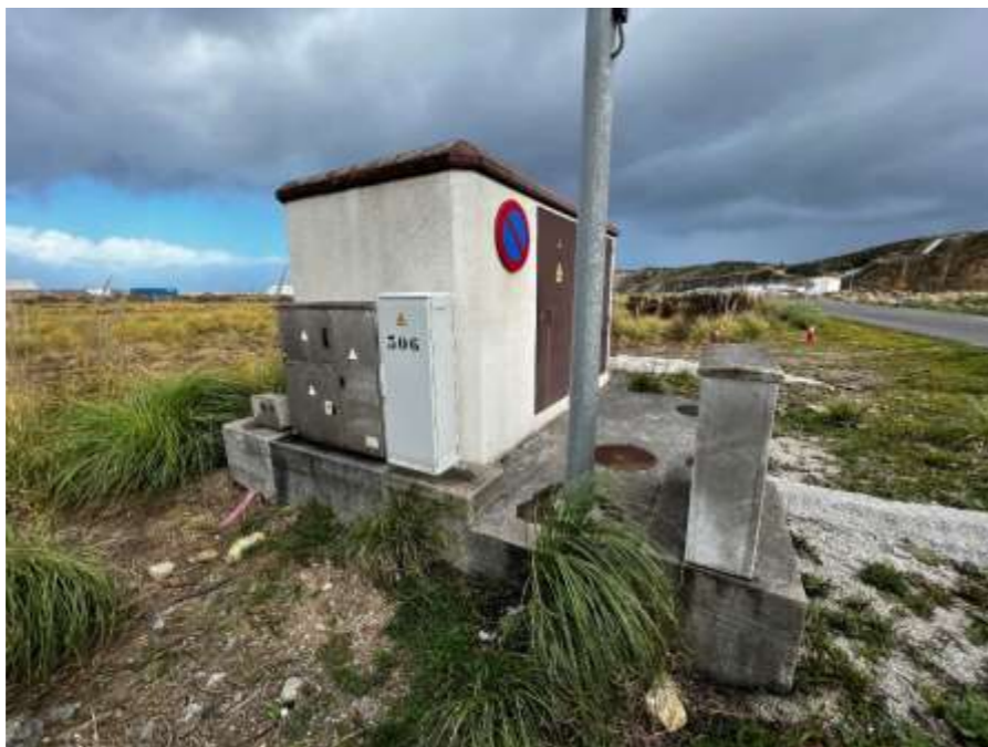
Foto 21. Centro de transformación existente
