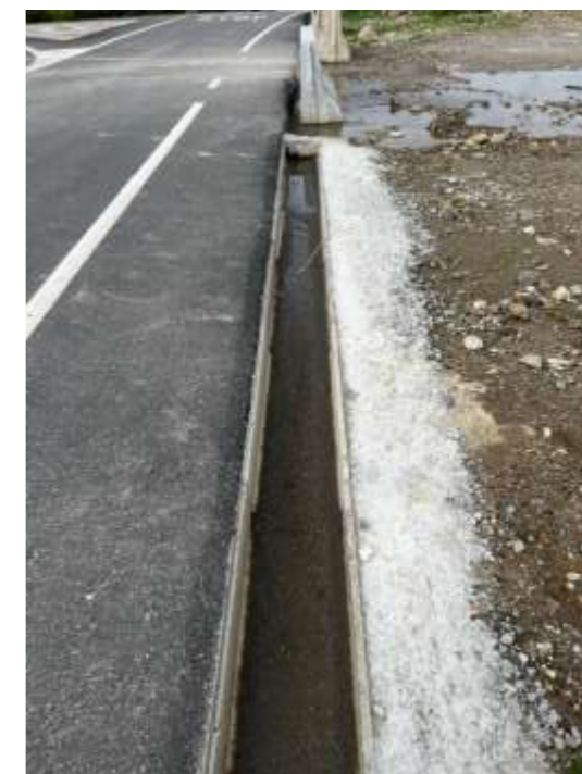
Foto 13. Canaleta Vial acceso a Repsol
