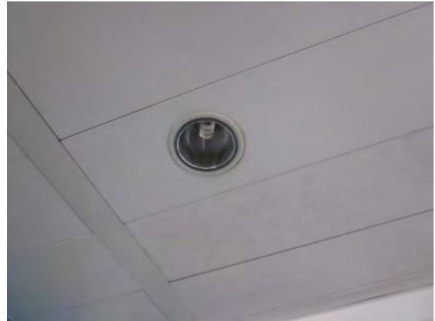
Figura 4.2.6 Lámpara de bajo consumo del edificio de Port Control
