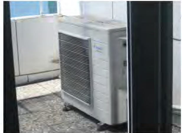
Figura 4.2.10 Bomba de calor – Unidad exterior
