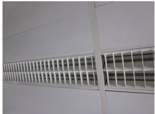
Figura 4.2.7 Fluorescencia lineal del edificio de Port Control
