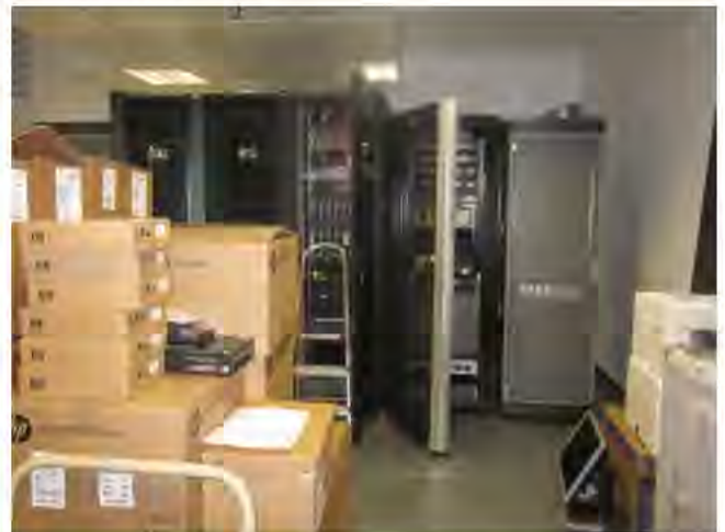
Figura 4.1.7 Armarios de racks del CPD de la sede de oficinas de la APT
