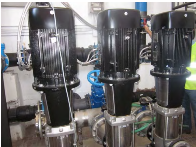
Figura 4.1.8 Motores de grupo de presión del muelle Aragón
