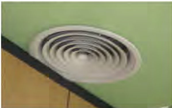
Figura 4.2.9 Difusor de techo
