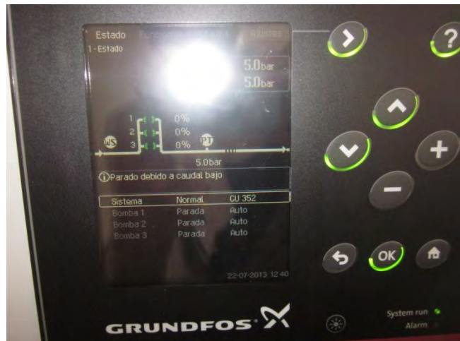
Figura 4.1.9 Interfaz del variador de frecuencia de los motores del grupo de presión del muelle Aragón
