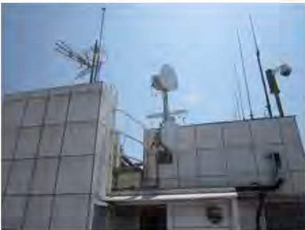
Figura 4.2.13 Otros consumidores – Equipos de control
